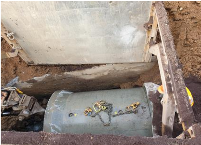
Hundertwasser stormwater line
