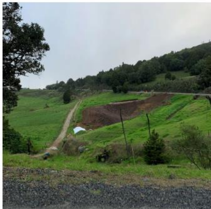
Ruapekapeka Rd – Detention Pond
